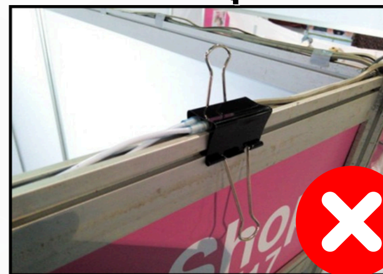
ห้าม หนีบช่องจุดต่อสายไฟ
